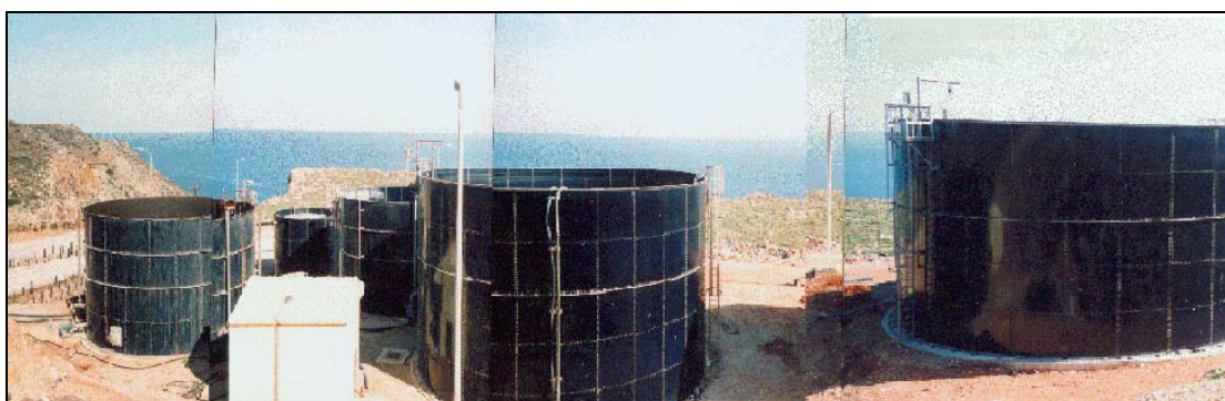
Εικόνα 8.18: Σύστημα επεξεργασίας στραγγισμάτων
