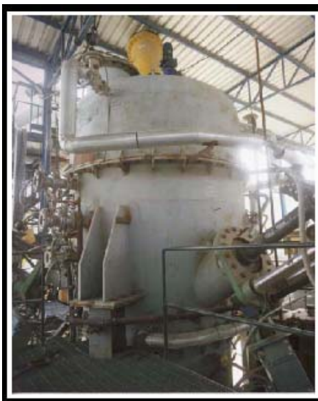
Εικόνα 2.2 : Εγκατάσταση αεριοποίησης [Φάττα Δ., 2006].
