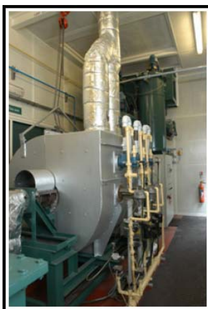
Εικόνα 2.1 : Εγκατάσταση πυρόλυσης [Φάττα Δ., 2006].
